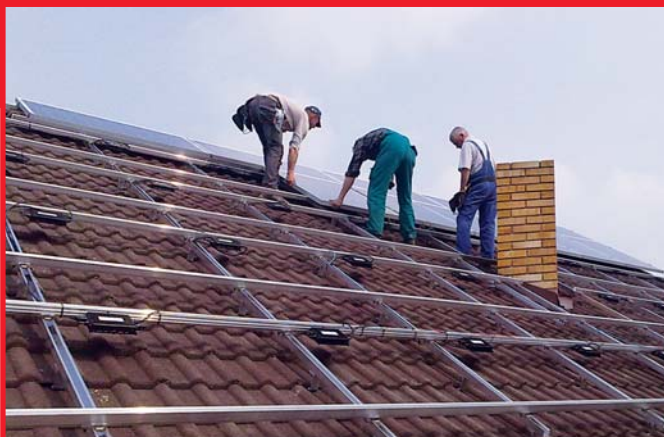
Systém SolarEdge instalovaný na střeše rodinného domu v ČR firmou SolarTeam. PowerBoxy jsou připevněny na konstrukci pod každým panelem.
